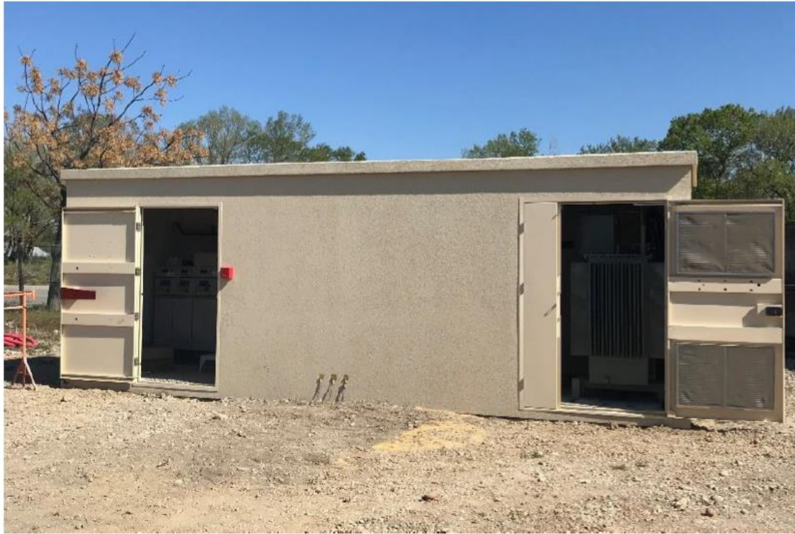
Figure 5 : Photographie d'un poste de livraison/transformation
